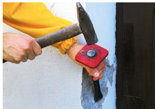
Atšokusį tinką ir kitas pažeistas vietas reikia pašalinti mechaniškai
